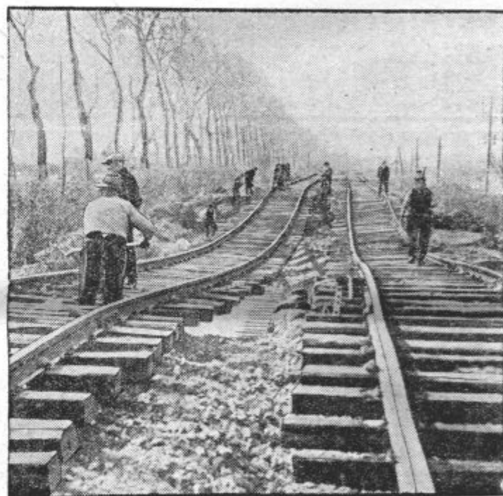
Železniška proga po povodnji
